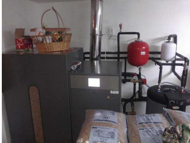
Figura 8. Vaso de expansión instalado.
